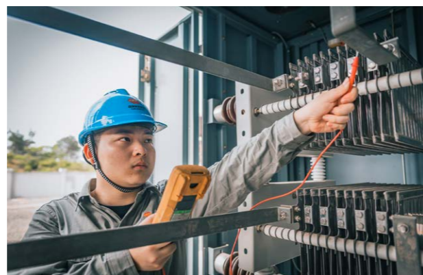
新能源公司开展接地变安全隐患排查行动
